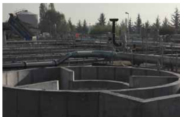
Fig. 5 – Il nuovo ripartitore al biologico
